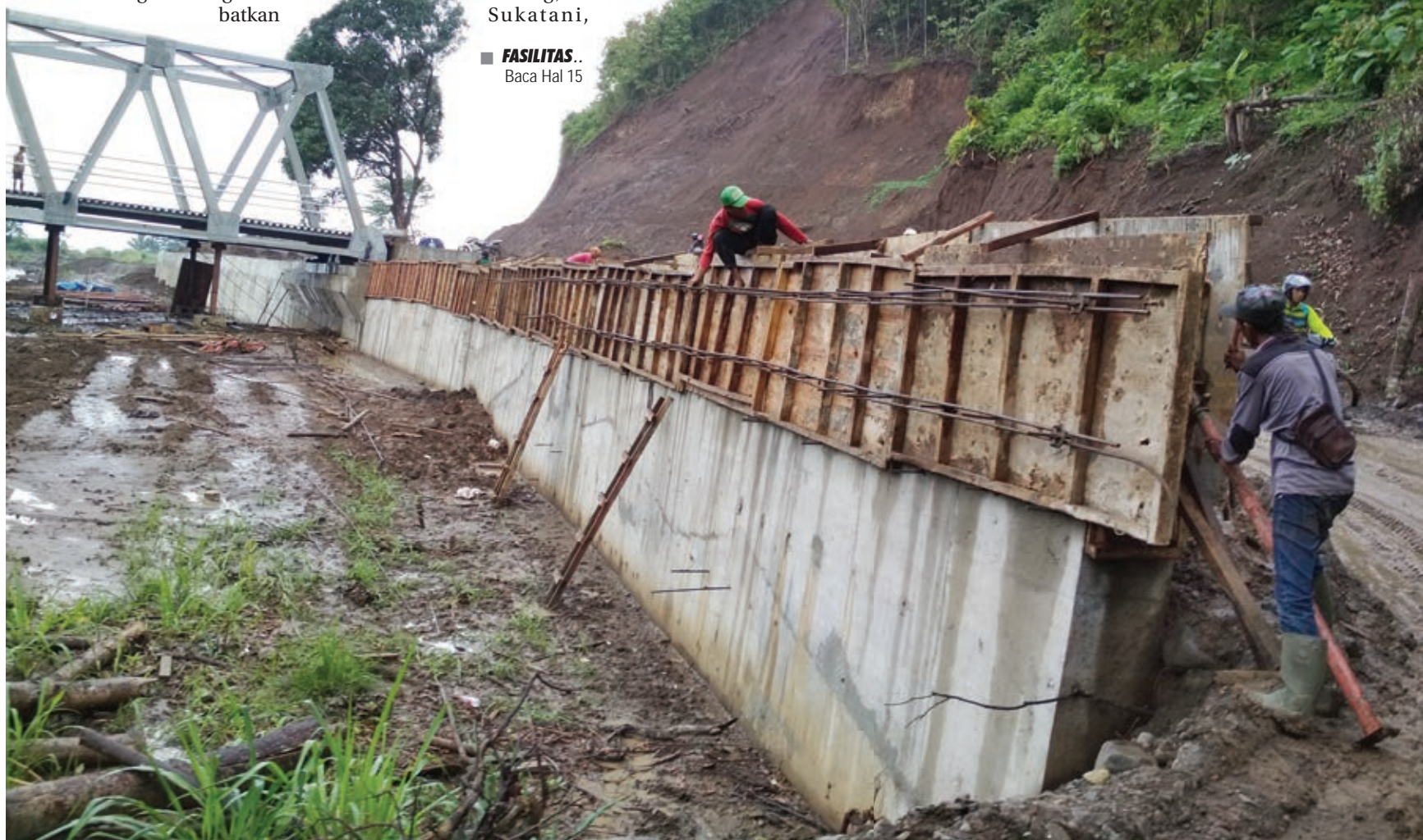
PROYEK: Kondisi Pembangunan jalan dan jembatan sebagai infrastruktur penunjang akses menuju kawasan Geopark Ciletuh Palabuhanratu.
